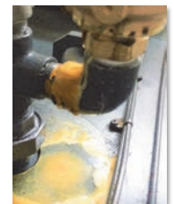
EO滅菌器の安全弁が吹いた後の様子
